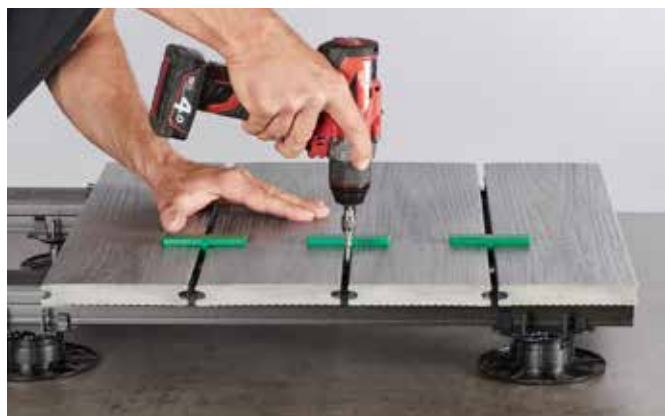
3. Montageklemmen weer vastschroeven
